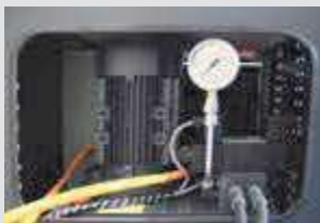
Agrégat hydraulique double circuit dans une substructure avec armoire
